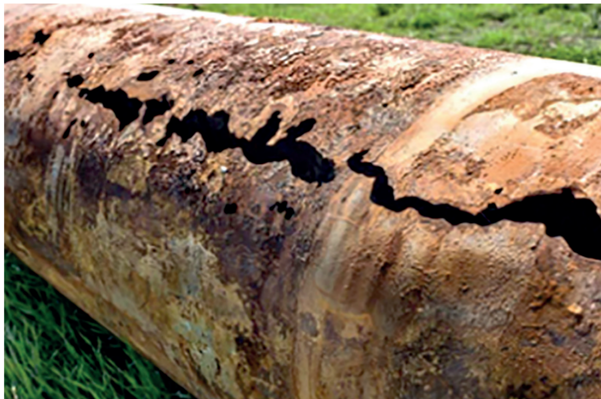
FIGURA 1. TUBERÍA deteriorada por un proceso de corrosión. [HTTPS://WWW.SHUTTERSTOCK.COM/ES/IMAGE-PHOTO/FRAGMENTS-OLD-LARGE-WATER-PIPES-AFTER-282324041]
