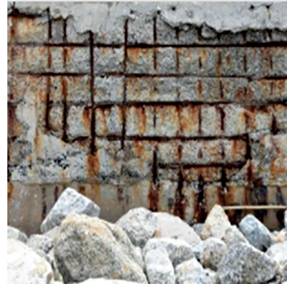
FIGURA 3. ACERO de refuerzo corroído. [HTTPS://WWW.SHUTTERSTOCK.COM/ES/IMAGE-PHOTO/STEEL-CORROSION-REINFORCED-CONCRETE-DAMAGED-RUSTY-1785638519].
