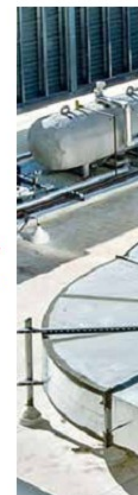
FIGURA 2. EJEMPLO de un sistema de radiación ultravioleta industrial para desinfección de aire. Tomada de https://www.nyfdecolombia.com/uv/modulo-de-desinfeccion
